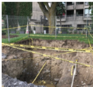
Tranchée (évacuation difficile)
